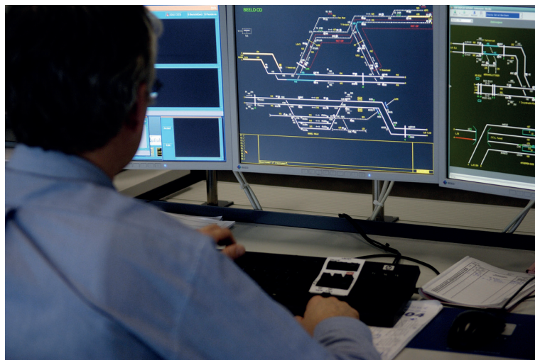
Illustration : partie commande d'un poste EBP
