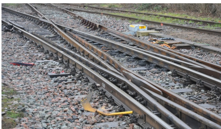
6 Skader i bl.a. tungepartiet i krydsningsspor 25 /24a
