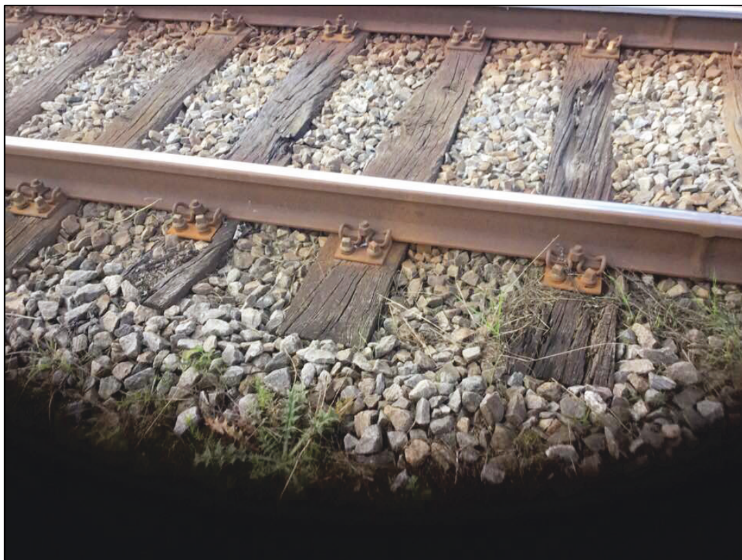
Foto 4 Vedhæftet foto fra tilstandsmeddelelse af d. 07-10-2019 ang. dårlige sveller.
