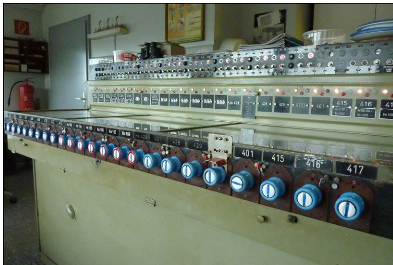
Abb. 2 Hebelwerk Bauform E43 Stw Esf
