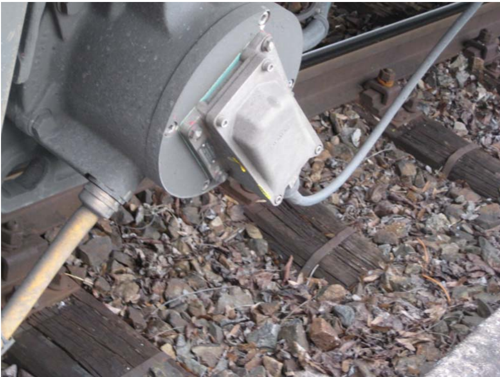
Abb. 7: Farbspuren am Taktgeber Quelle: DB Netz AG
