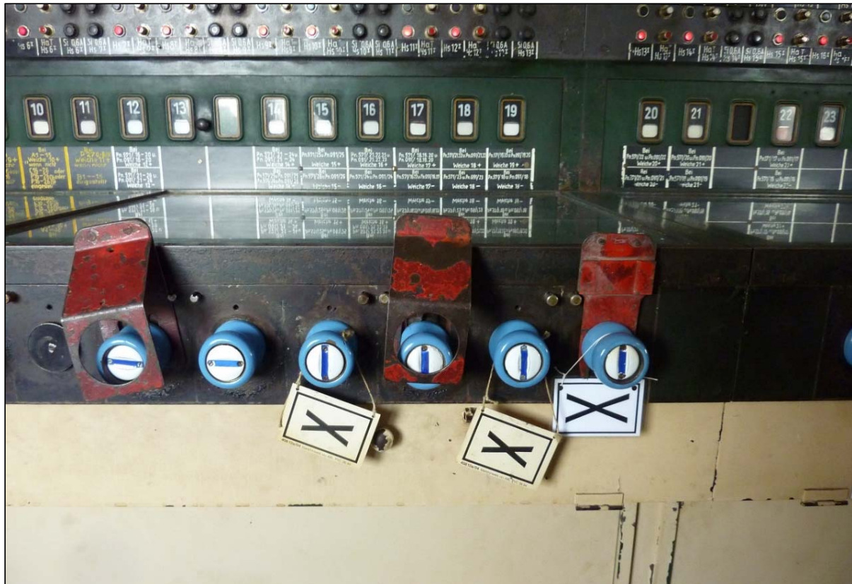
Abbildung 5: Hebelwerk E 43 mit Merkhinweisen und Hilfssperren
