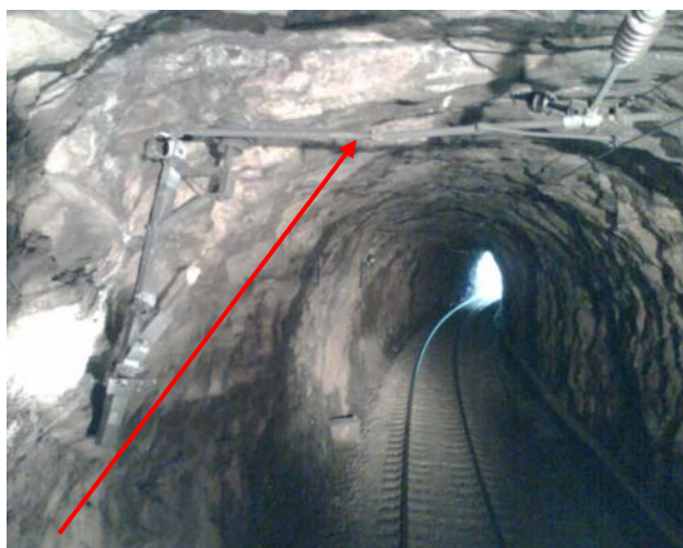
Figur 2: Viser skadet utligger for kontaktledningen.
