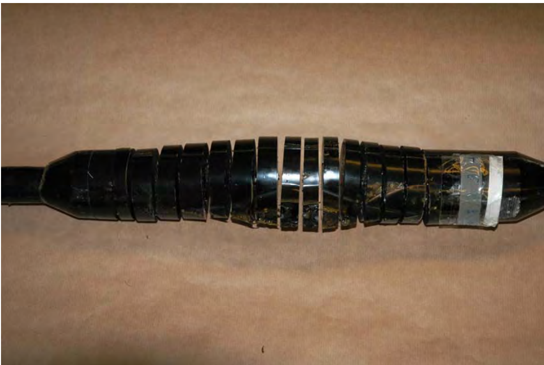
Figur 1 Oversiktsbilde av kabelmuffe etter seksjonering.
