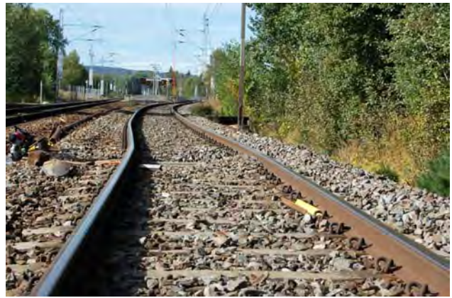
Figur 6: Sideveis forskyvning av skinnegangen som følge av kraften mot venstre skinne.
