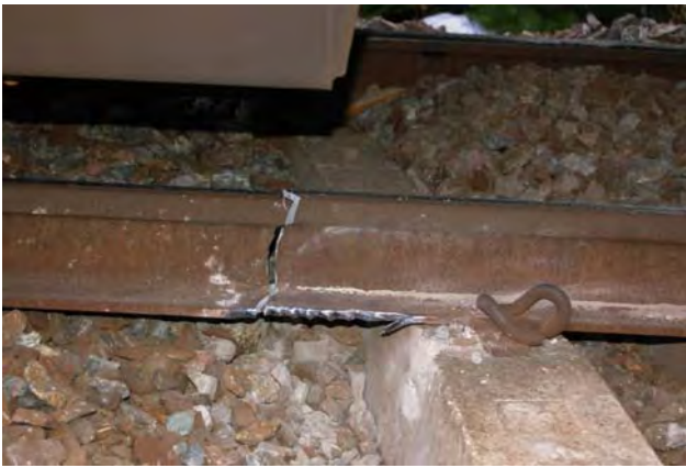
Figur 5: Merker etter en kraft mot venstre skinne i hovedspor Lillestrøm - Oslo S
