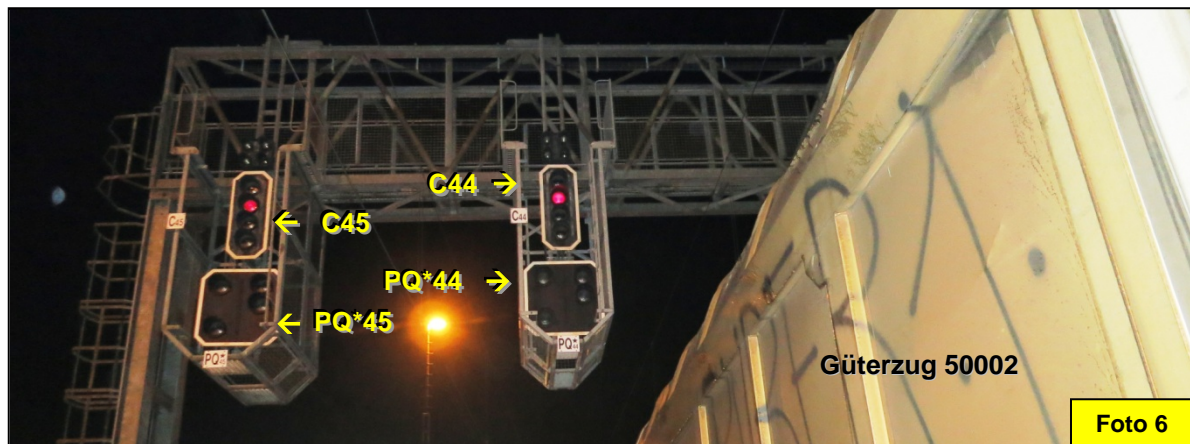
Signalbrücke in Lenzburg Ausfahrt Olten (C45 nach Unfall, korrekterweise auf Halt)
